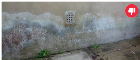
L'enduit ciment sur un mur en pierre empêche l'eau de s'échapper et entraînera une dégradation du mur, de la structure, une humidité intérieure...
