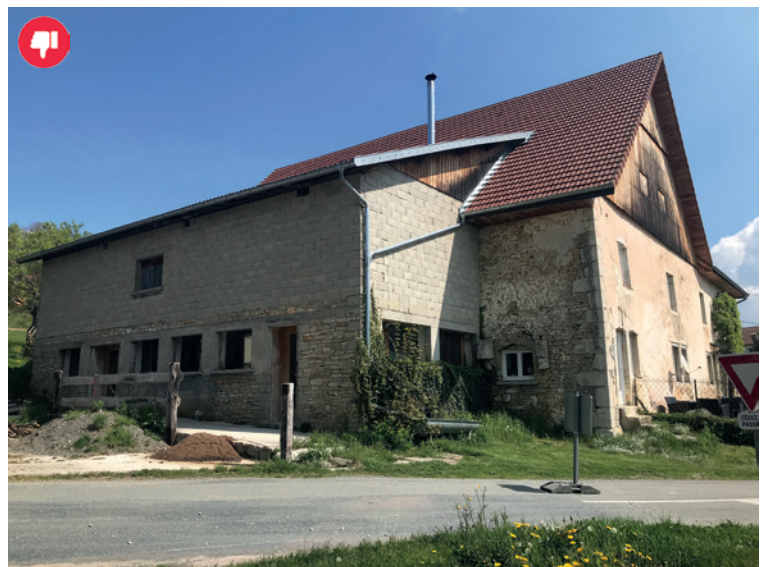
La reprise en parpaing de l'extension, réalisée sans enduit, nuit à la qualité d'ensemble du bâtiment.
